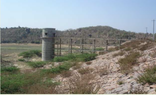
న్యాల్యల్ నీటి పథకం కింద నిర్మించిన సమ్మర్ స్టోరేజీ ట్యాంకుకు నీరుగానీ, పంపులుగానీ లేని దృశ్యం
