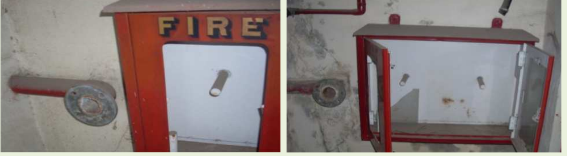
గగన్ విహార్‌లో పనిచేయని డీ హైడ్రెంట్ సిస్టమ్ (2012 జూలై 12)
