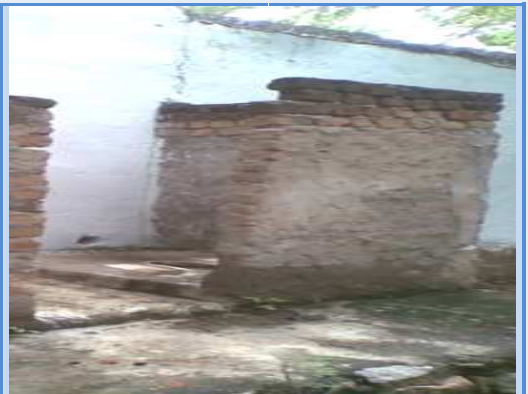
గ్రామ పంచాయతీ : తుమ్మల చెరువు మండలం : ఘట్టు జిల్లా : మహబూబ్ నగర్ తలుపు, పైకప్పు, నీళ్ళులేని మరుగుదొడ్డి
